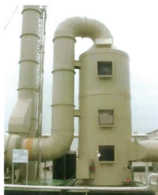
填料塔与旋流板塔组合吸收装置工程
