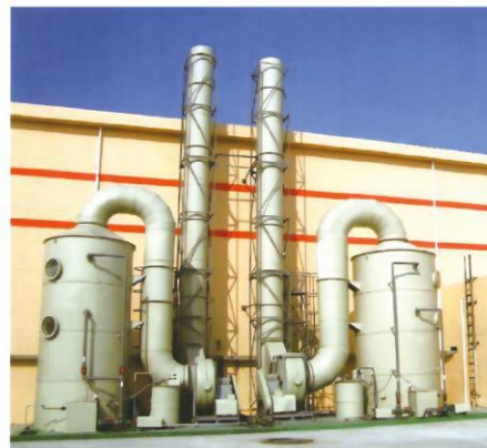
多级填料塔吸收装置
